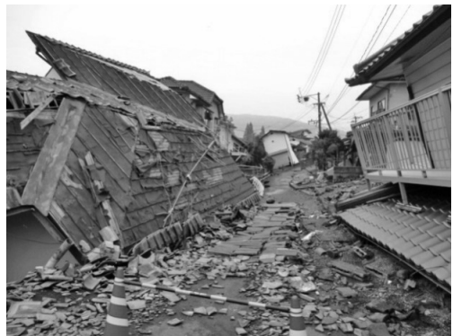
写真 8 益城町文化会館周辺の状況
